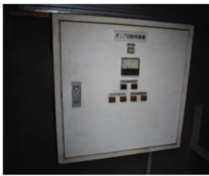
☞制御盤交換前
