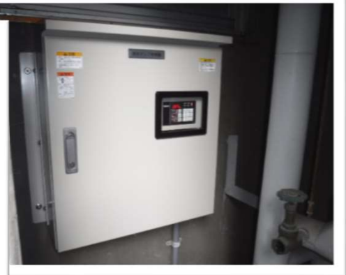
☞制御盤交換後
